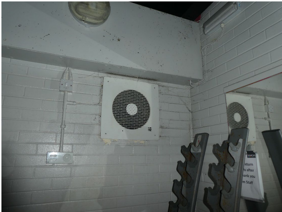
Gym Local Extract Fan
