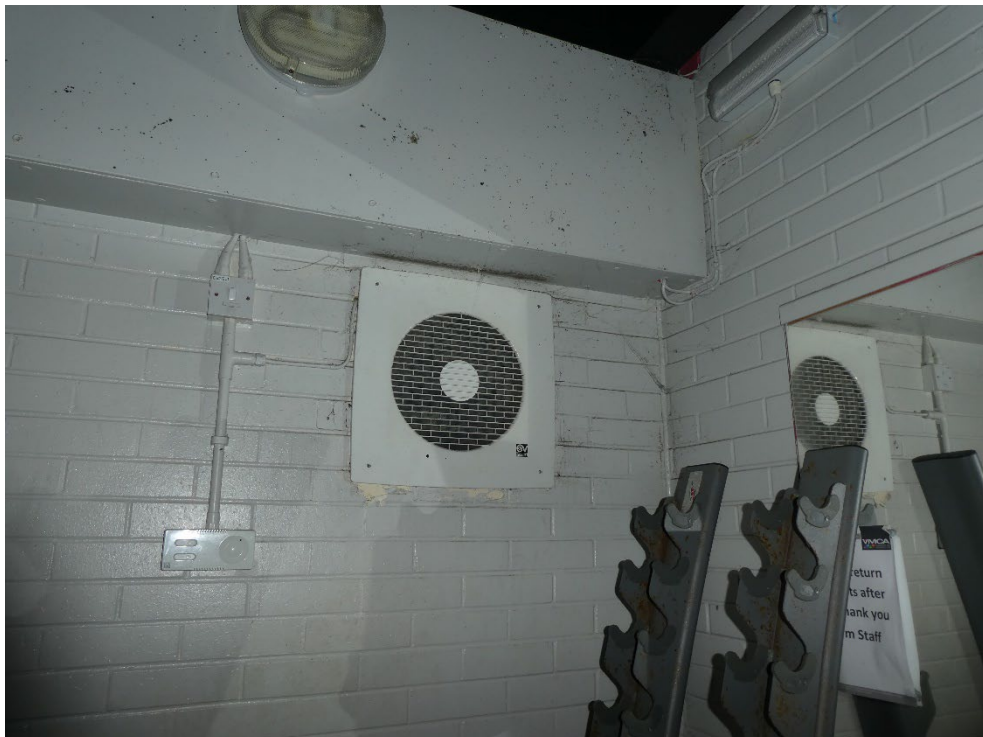
Gym Local Extract Fan
